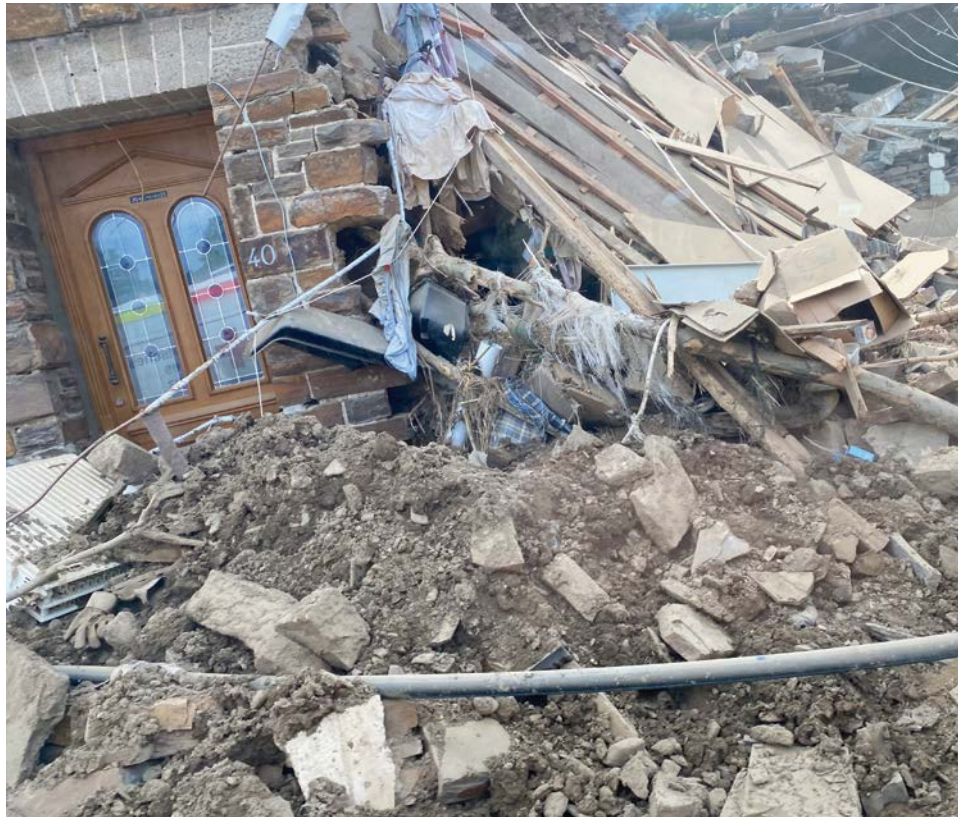
Die Wassermassen brachten ganze Häuser zum Einsturz
